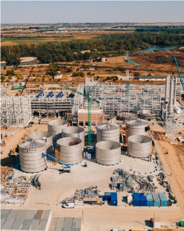
DESCRIERE FOTOGRAFIE: IMAGINEA CURENTĂ A ȘANTIERULUI UNDE SE CONSTRUIEȘTE FABRICA CLARIANT SUNLIQUID®, PODARI, ROMÂNIA (CREDIT FOTO: CLARIANT)
